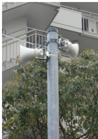
1号棟 北側(ポール)
